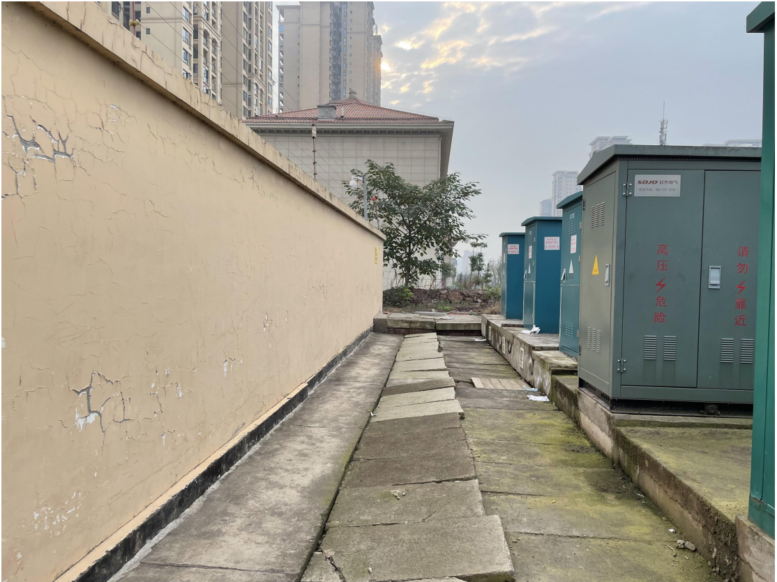
照片一 齐家 110kv 变电站
